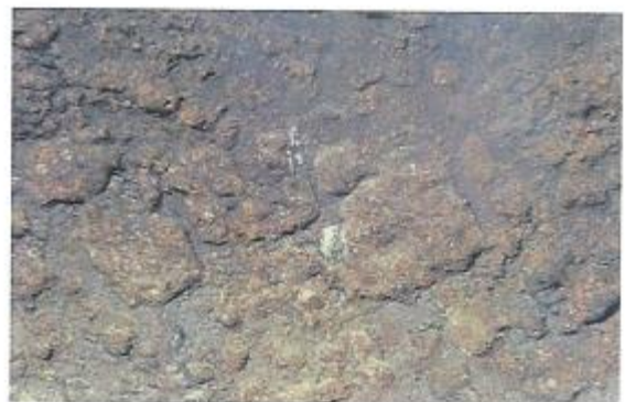
Corrosion généralisée (aspect après grenailage)
