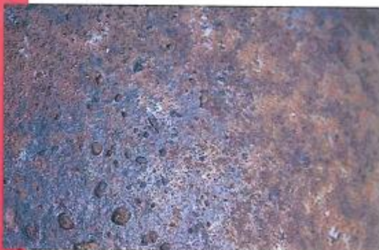
Corrosion généralisée (aspect après grenailage)
